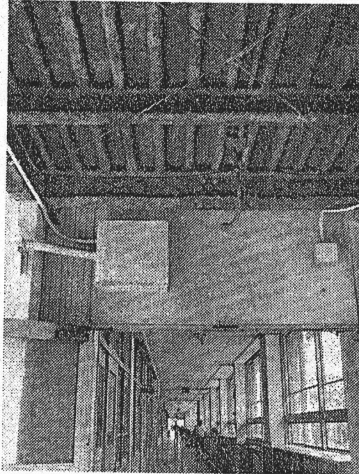
石綿使用が確認された堺市立新金岡小の渡り廊下の天井(はん点のように見えるのがボールを投げつけた跡)
