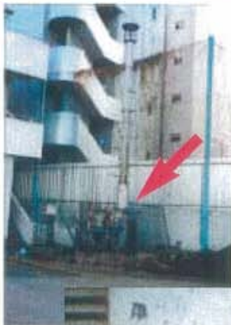
廃棄物焼却炉
