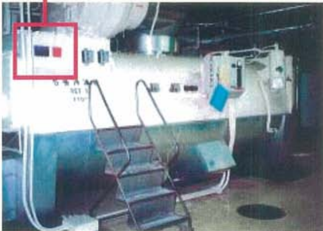
ターボ冷凍機
