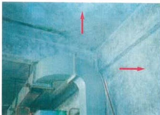
吸音用吹付け石綿・石綿含有吹付けロックウール (天井・壁)
