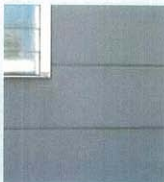
石綿板（窓業系サイディング）
