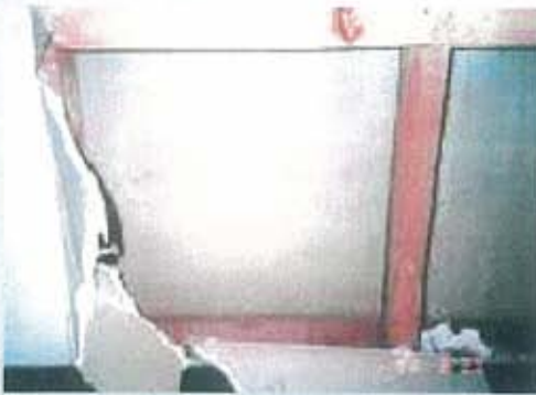
砒素・カドミ含有石膏ボード
