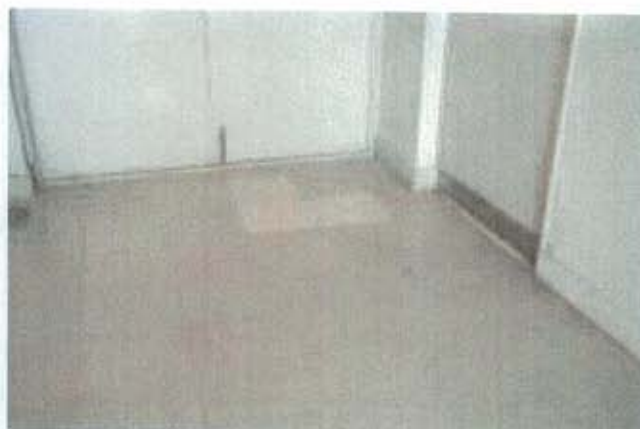
石綿含有ビニール床タイル（床）
