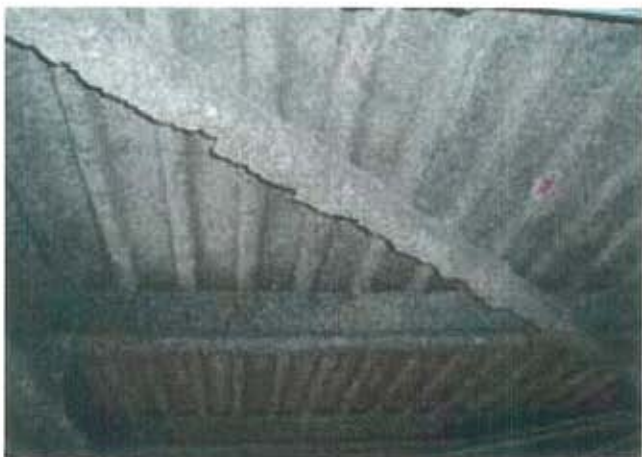
断熱用吹付け石綿・石綿含有吹付けロックウール (折版屋根裏、デッキプレート床裏、階段裏・庇裏等の断熱)
